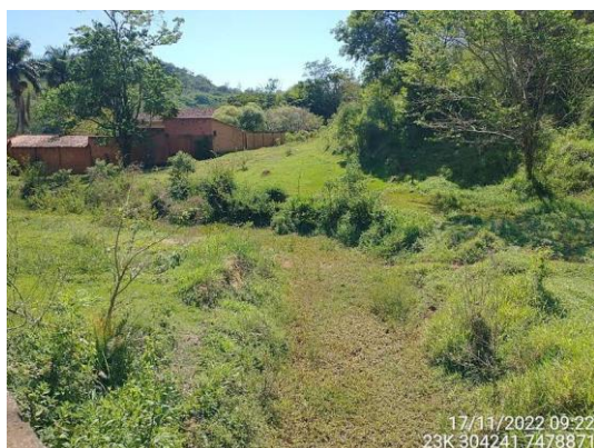
Foto 5 – Drenagem com acúmulo de sedimentos. Ponto 5. (Data: 17/11/2022).
