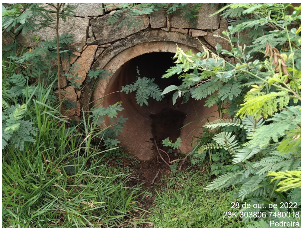
Foto 3.2.1-2. Ausência de escoamento superficial na tubulação à altura do P07.
